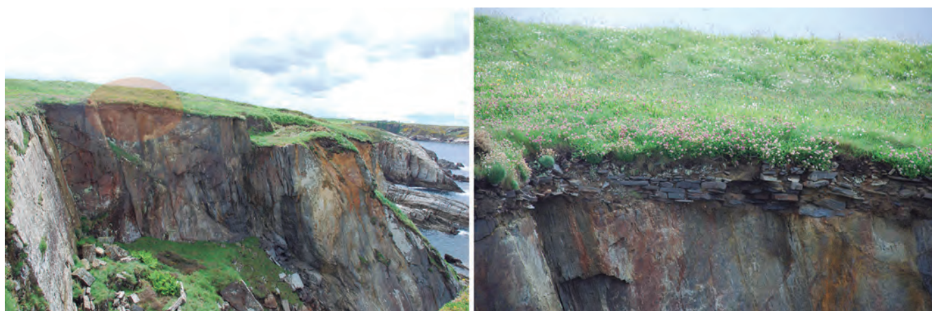
FIGURA 4: Castro de Cabo Blanco, Valdeparés (El Franco). Lienzo de pared correspondiente a una vivienda del siglo I d. C. colgada sobre la línea de acantilado tras el colapso del frente costero.
